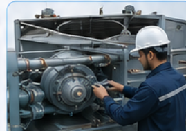
FAN & GEARBOX SERVICE
